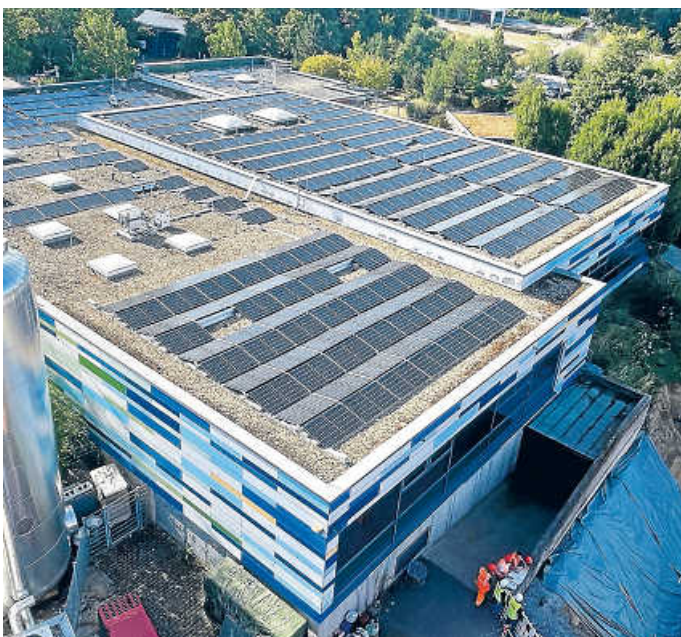
Neue Photovoltaikanlage auf dem Hallenbad Foto: Stadt Öhringen
